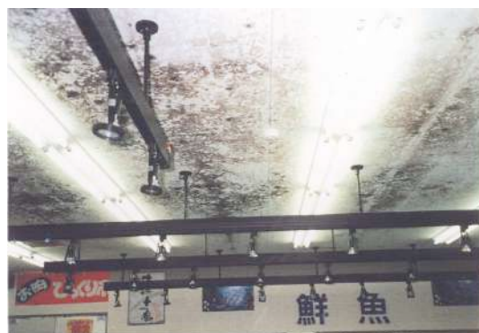
防カビ施工前の状態
