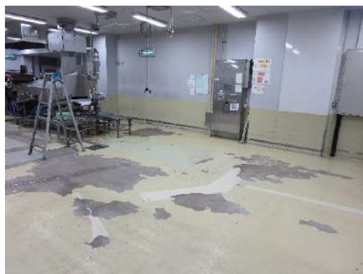
床面の補修前の状態
