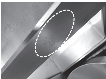
写真1 ラインの機器内に洗浄不足で油が残っている
