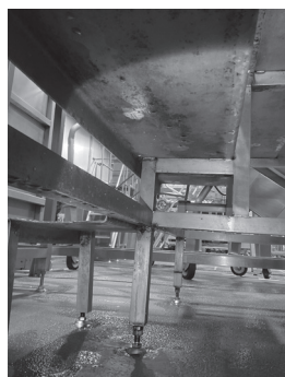
写真4 作業台裏側に汚れやカビが堆積している様子
