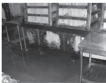
写真3 不適切な洗浄作業の結果 日常的に高濃度の次亜塩素酸ソーダ希釈液の散布を続けた結果、設備に広範囲な錆が発生している
