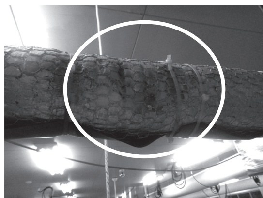
写真2 ダクト管の断熱材が劣化したままに放置されている
