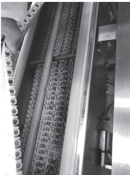
写真2 コンベア内側に堆積した汚染
