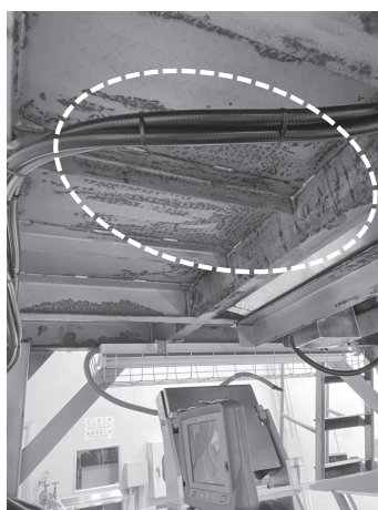
写真2 ライン上の架台裏側に堆積した汚れ
