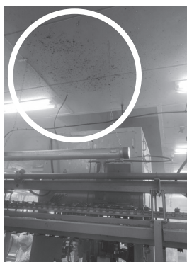
写真2 ライン直上の天井面に付着した汚れ
