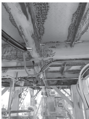
写真1 環境管理が不十分な結果の例① 架台裏側にカビと油汚れの堆積 が拡大している
